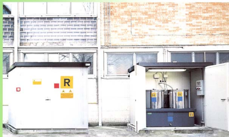
BOX DI COPERTURA RACCOLTA CENTRALIZZATA
